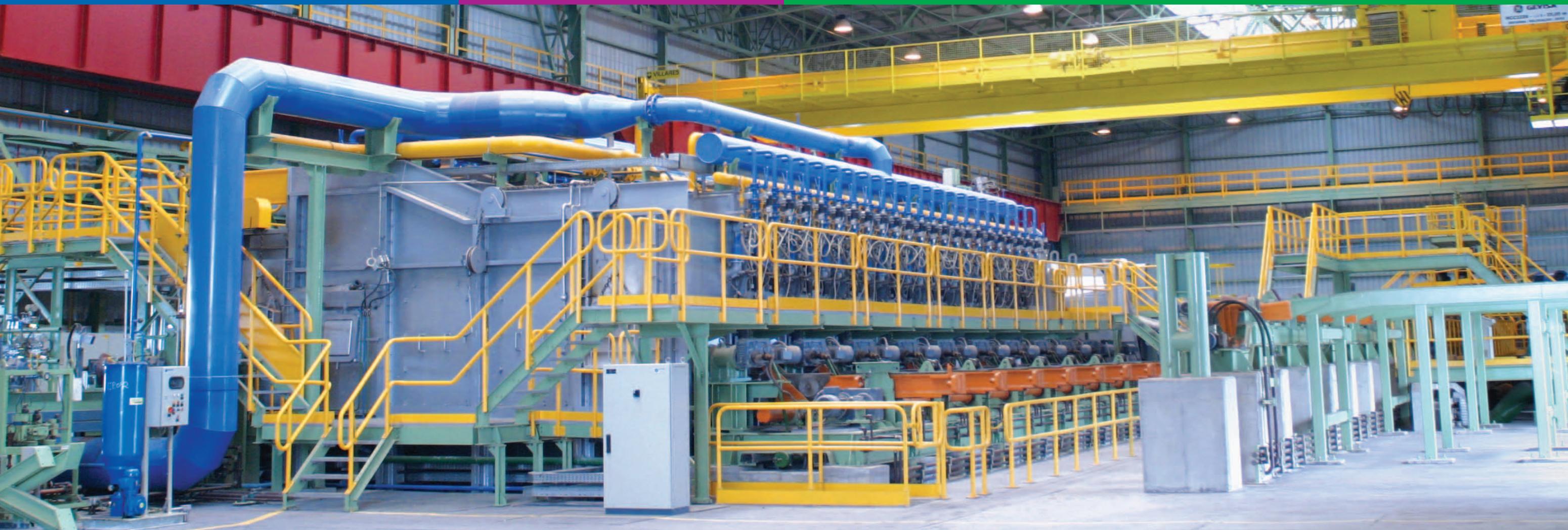
Planta de Tratamento Térmico TenarisConfab em Pindamonhangaba, São Paulo.
